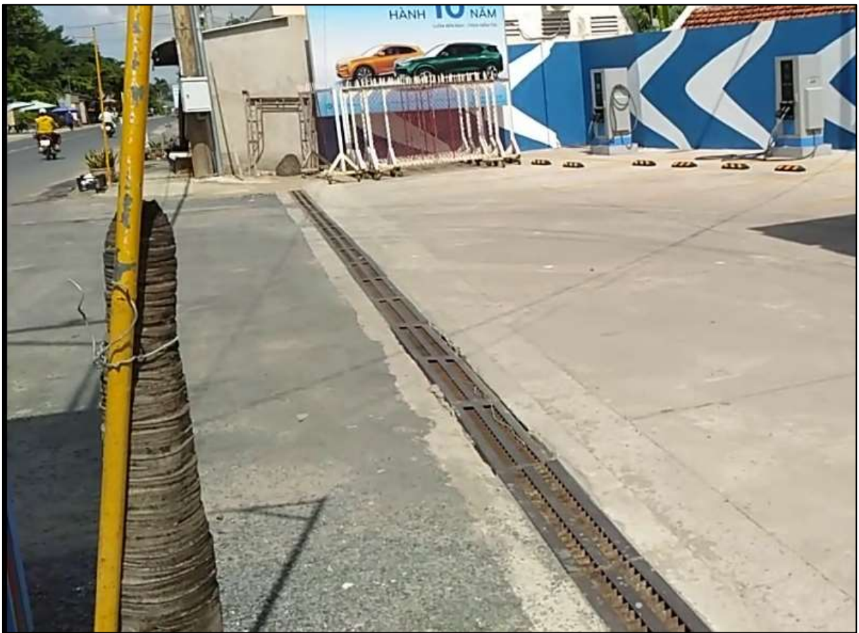
Hình 3.3. Rãnh thu gom nước
